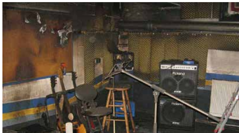
Elektroinstallation im Musikübungsraum der Kirche verursacht Brand.
