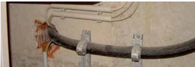
Bild: Eine nicht geschlossene Durchführung leitet im Brandfall Feuer und Rauch weiter.
