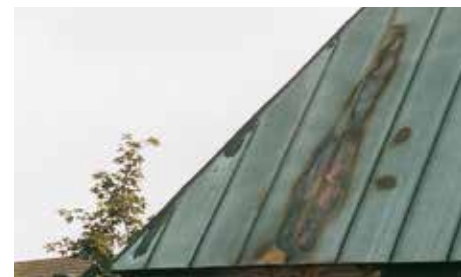
Brandspuren der in Brand geratenen Unterkonstruktion des Daches.
