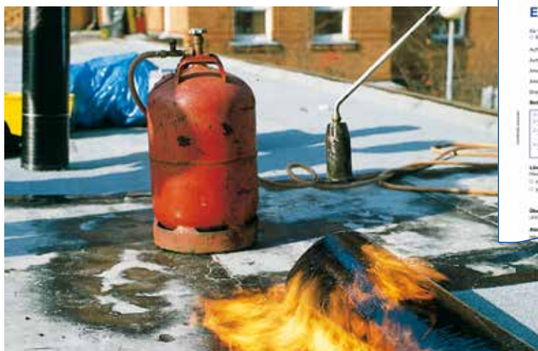
Brennbare Gase – möglichst nur den halben Tagesbedarf bereitstellen.
