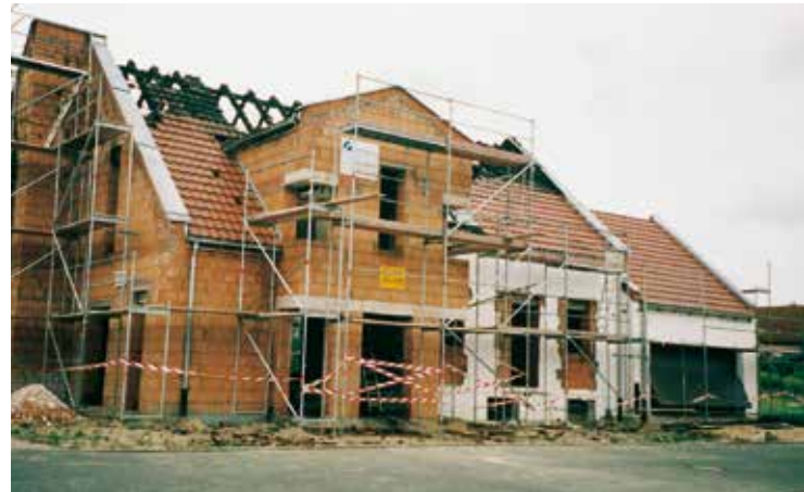
Abgebrannter Dachstuhl aufgrund unzureichender Brandschutzmaßnahmen während der Bauarbeiten.
