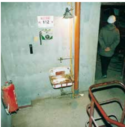
Organisatorischer Brandschutz im Treppenraum einer Großbaustelle: Feuerlöscher, Telefon mit Notrufnummern, Feuerschutztür bereits eingebaut.
