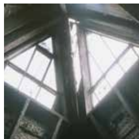
Innenansicht der ausgebrannten Dachspitze.
